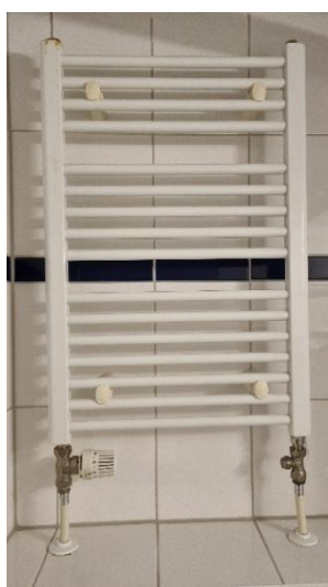
Fig. 4: Radiador de baño
